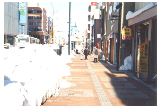
Photo 1: Etat du chauffage routier dans le trottoir
