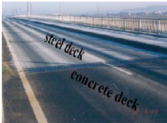
Fig.17 Etat du givre sur un pont
