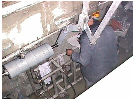
Tuyauterie dans le bac à fondre les neiges (échangeur de chaleur)
