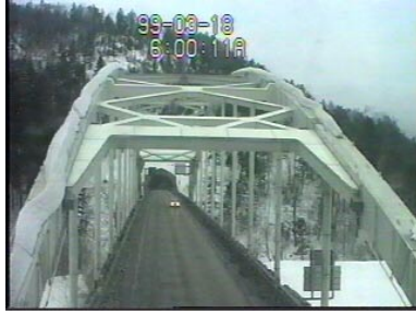
Photographie 1 Accumulation de la neige
